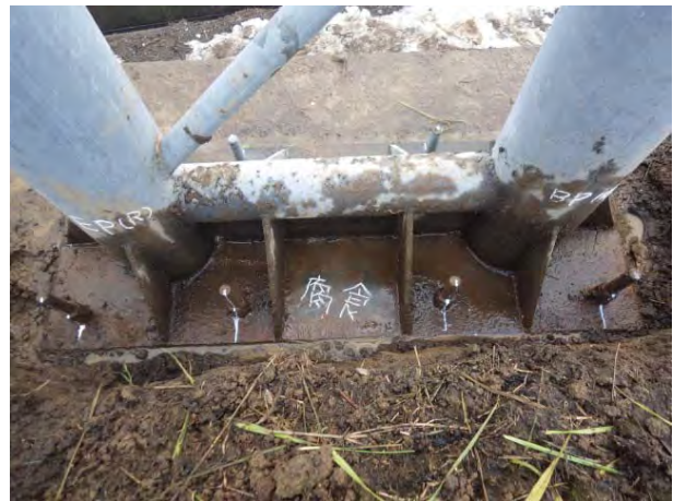
ベースプレートの腐食の例
