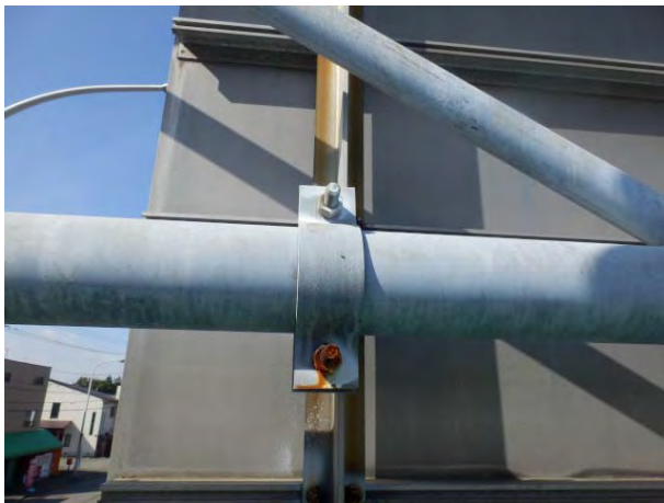
標識板継手の腐食の例
