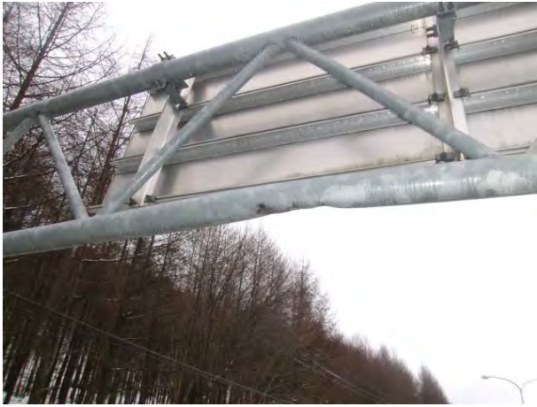
横梁の変形の例
