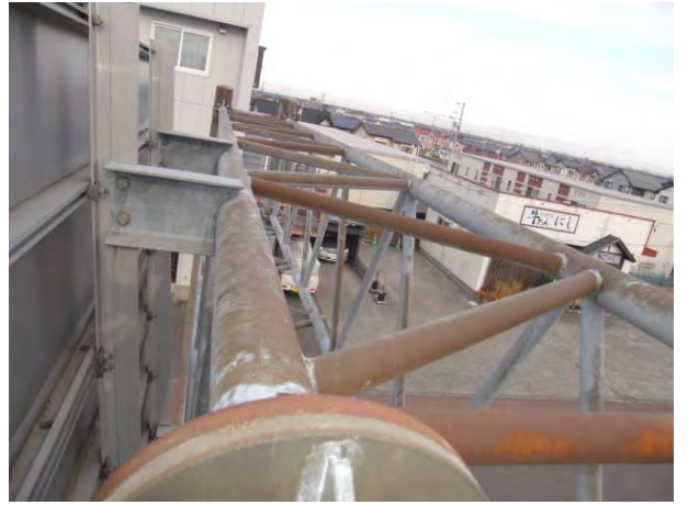
横梁の腐食の例
