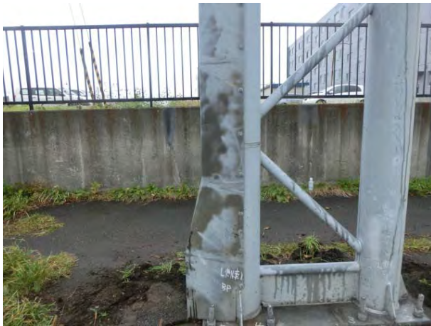
支柱の変形の例
