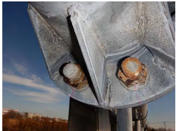
継手部ボルトの腐食の例
