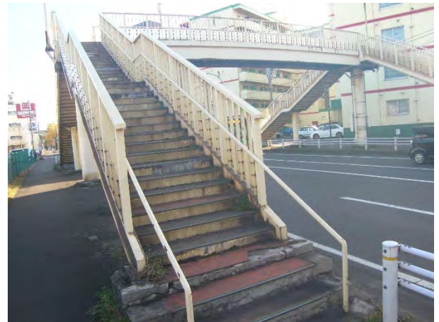
階段部の腐食例
