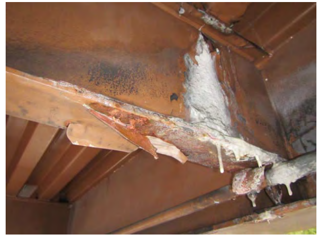
漏水による腐食例
