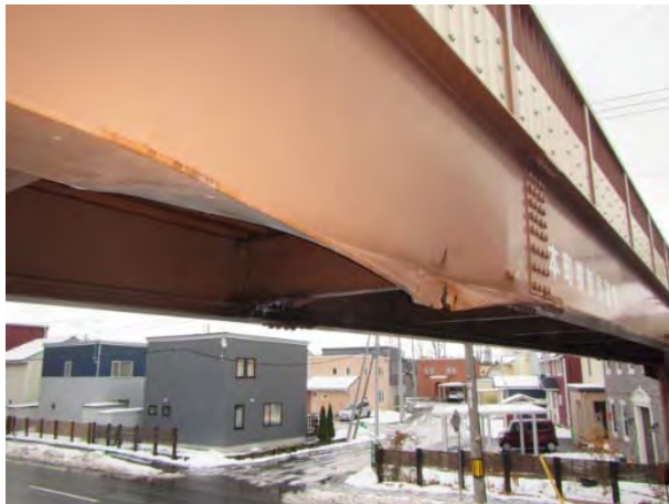
鋼製部材の変形（亀裂）例
