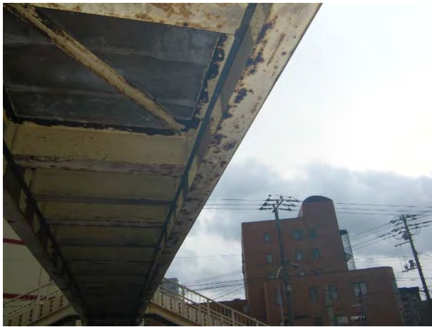
鋼製部材の腐食例
