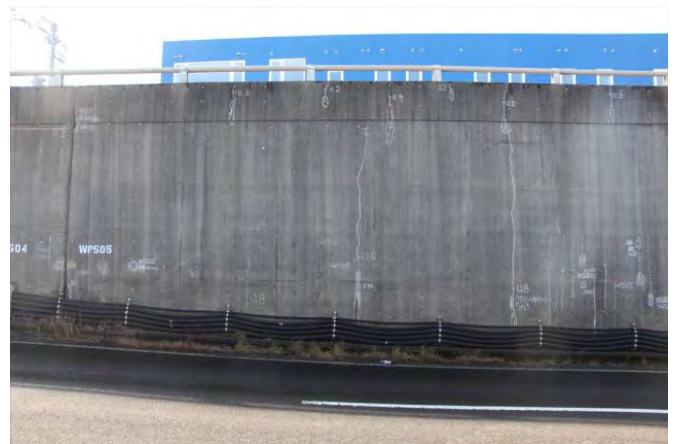
擁壁のひび割れ例
