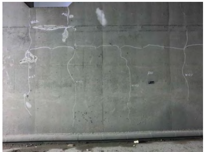
主部材のひび割れ例
