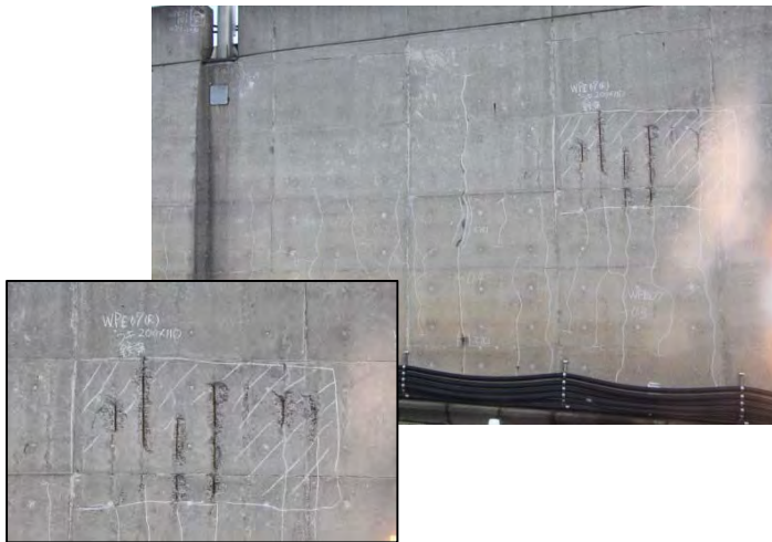
主部材のはくり例
