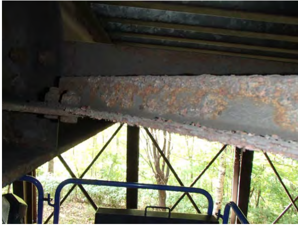
鋼製部材の腐食例
