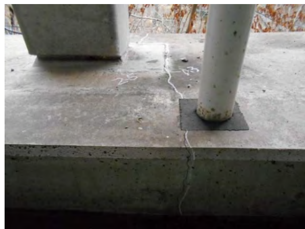
受台のひび割れ例
