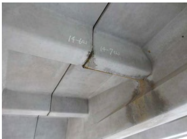
目地からの漏水例
