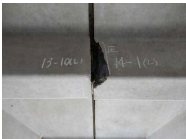
主部材のはくり例
