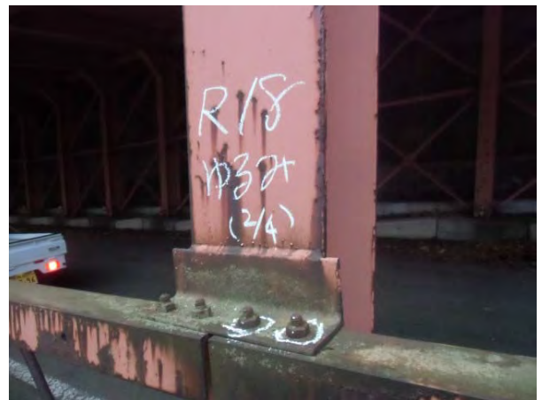
鋼製部材のゆるみ例
