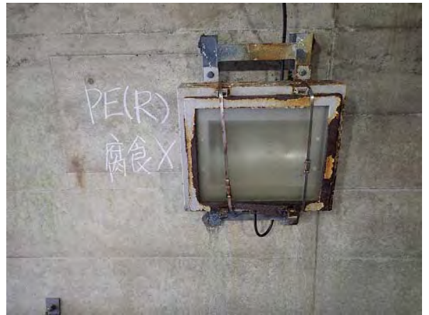
附属施設の腐食の例
