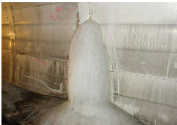
漏水（氷柱）の例
