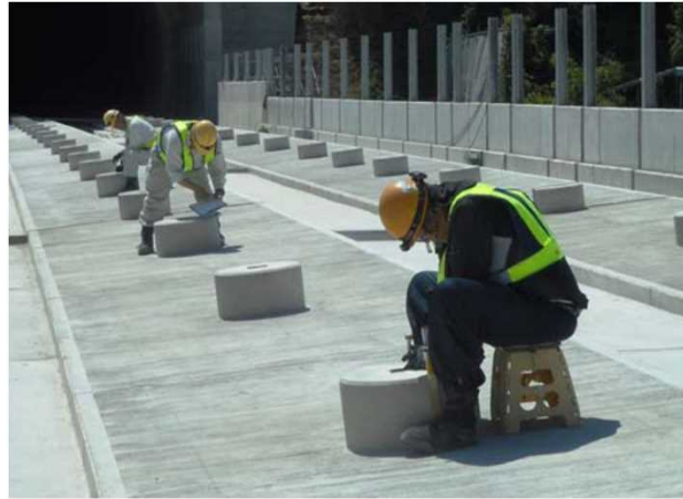
基準器設置状況
