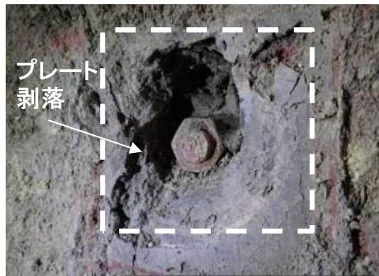
ロックボルトの変状状況
