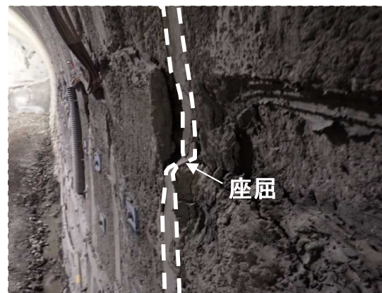
支保工の座屈状況
