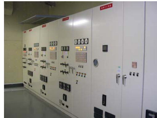
コ・ジェネレーションシステムの電力を制御する部分です。
