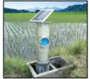
画像：自動水管理システム
