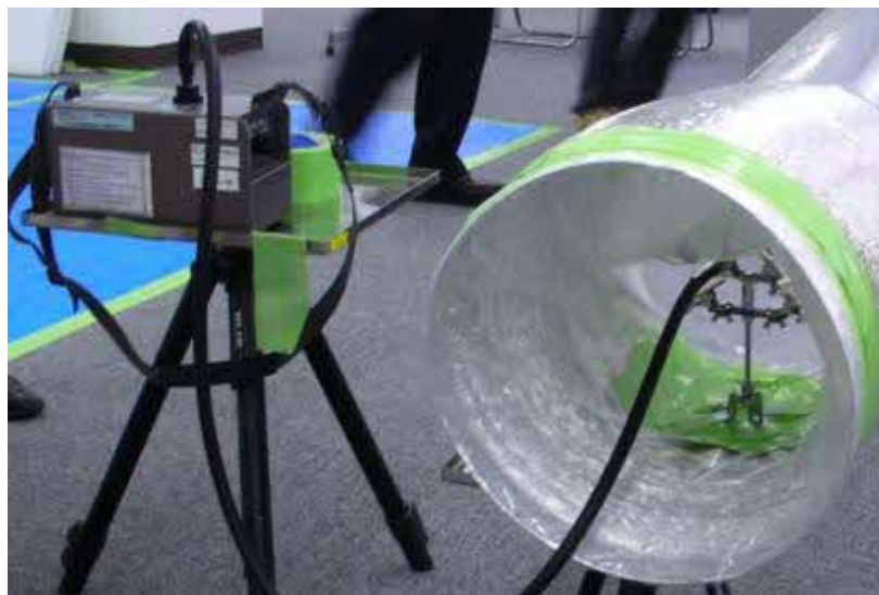
②集じん・排気装置が正常に稼働していることの確認方法の例 (デジタル粉じん計による確認)
