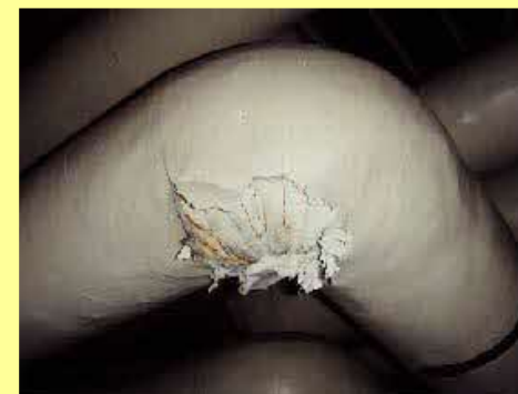
アスベスト保温材 (配管の断熱被覆)
