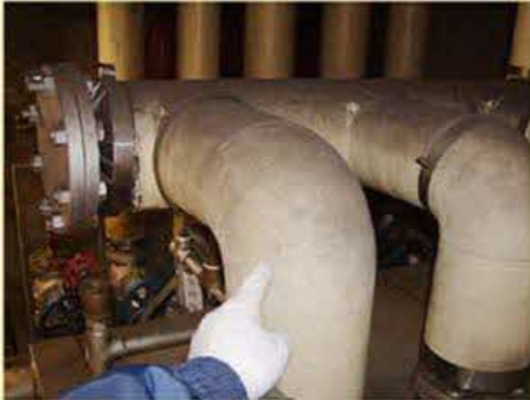
配管エルボ部分の石綿保温材 外観
