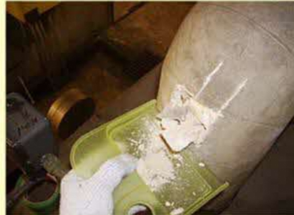
配管エルボ部分の石綿保温材 のサンプリング採取状況
