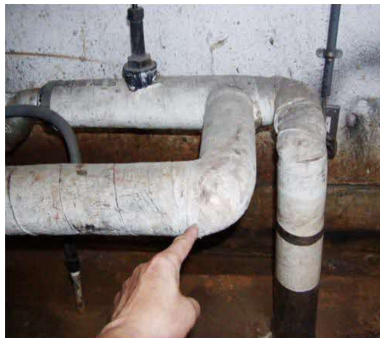
配管エルボを覆う石綿含有保温材
