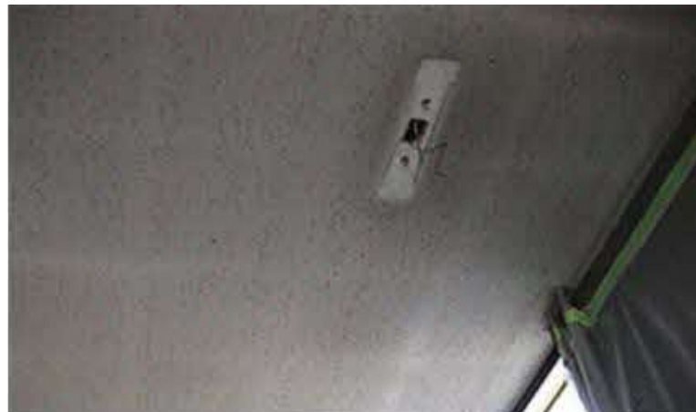
石綿含有ロックウール吸音天井板
