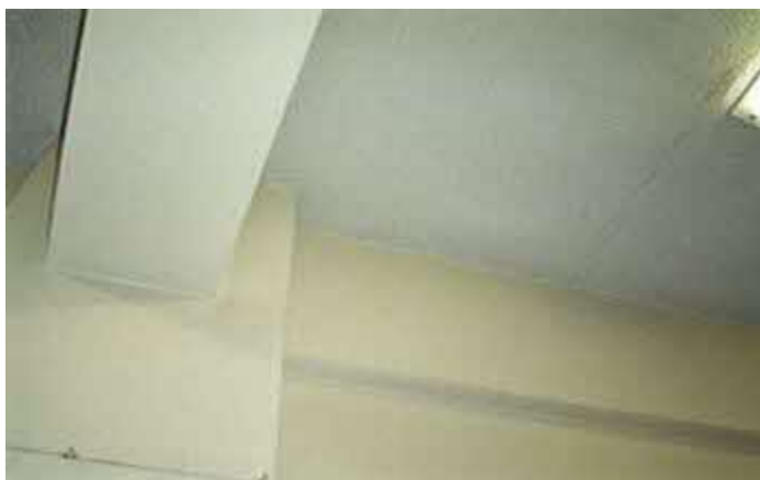
石綿含有吹付けひる石
