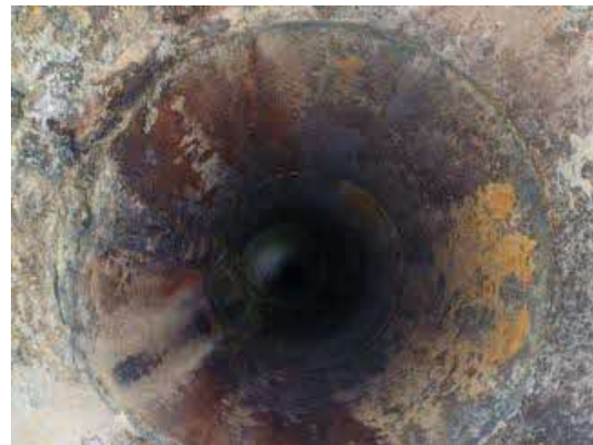
煙突石綿断熱材
