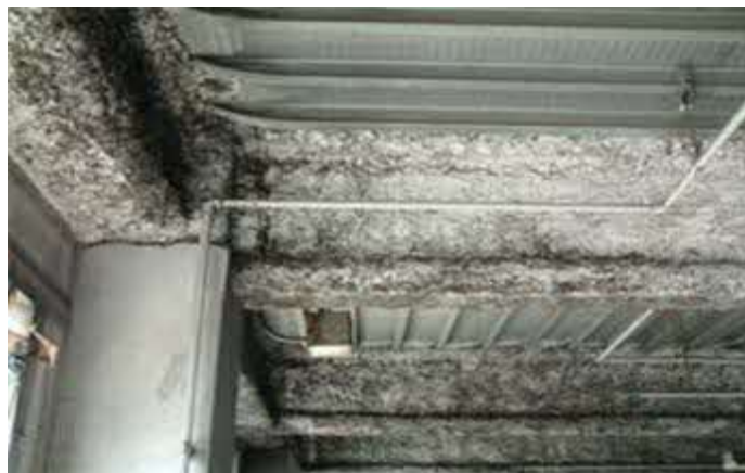
石綿含有吹付けロックウール
