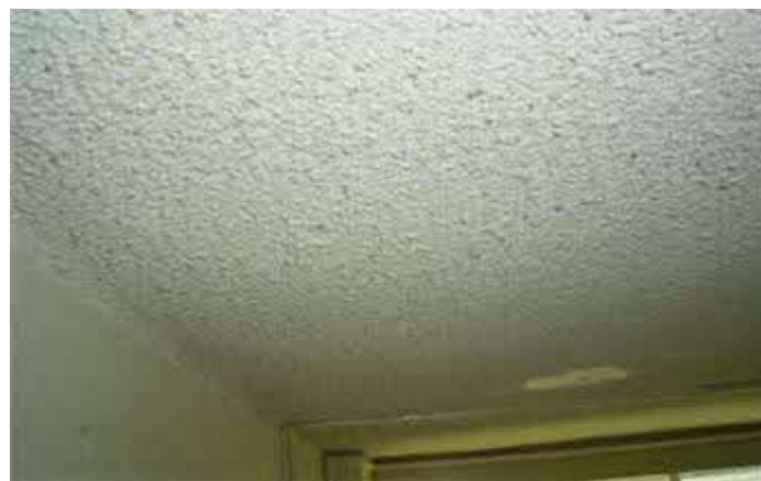
石綿含有パーライト吹付け
