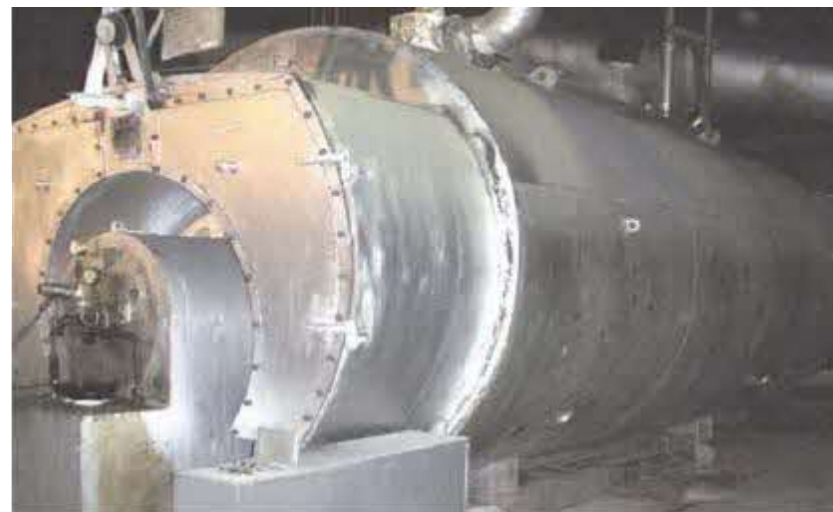
ボイラー保温材
