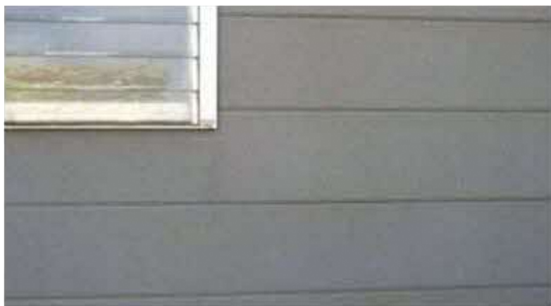
石綿セメントサイディング
