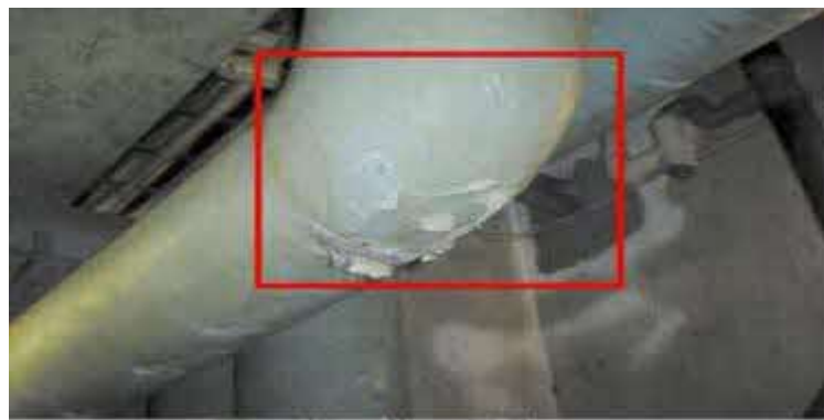
石綿含有保温材(配管保温用)
