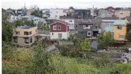
第12図 大曲川右岸で発生した斜面崩壊とそれに伴う擁壁の崩落。 Fig. 12 Slope collapse and deformed retaining wall at the right bank of Omagari river.
