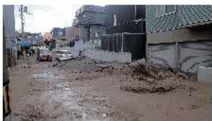
第22図 地盤のバルジ状隆起(里塚西北部)。
