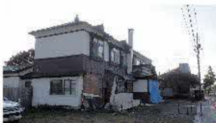
第42図 損傷した木造家屋(むかわ町松風). Fig. 42 Damaged wooden house at Matsukaze, Mukawa Town.
