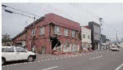
第37図 損傷した木造家屋(安平町早来). Fig. 37 Damaged wooden house at Hayakita, Abira Town.
