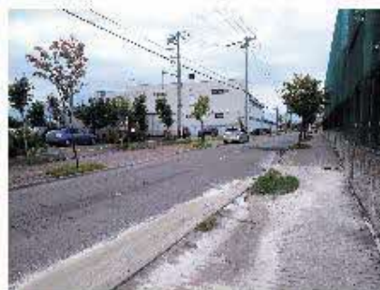
第27図 美しが丘小学校北側における地盤沈下。 Fig. 27 Subsidence at the northern area of Utsukushigaoka-kita elementary school.
