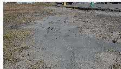
第6図 苫小西港における噴砂。 Fig. 6 Liquefied sand boil at the Tomakomai west port.
