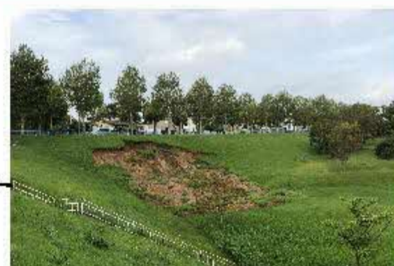
緑地法面の崩壊（青葉第2緑地）
