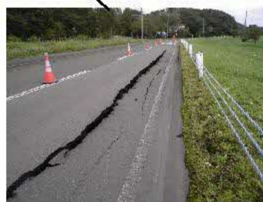
路面地割れ（市道音江別高台線）
