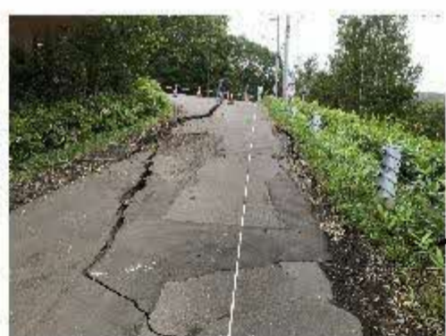
路面地割れ（市道西の里中央通線）
