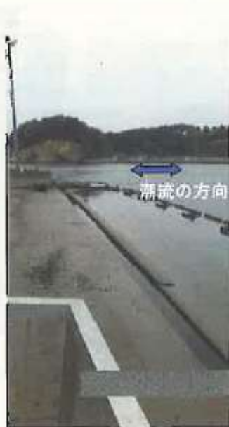
沈下した護岸
