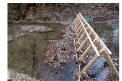
木製流木除け工
