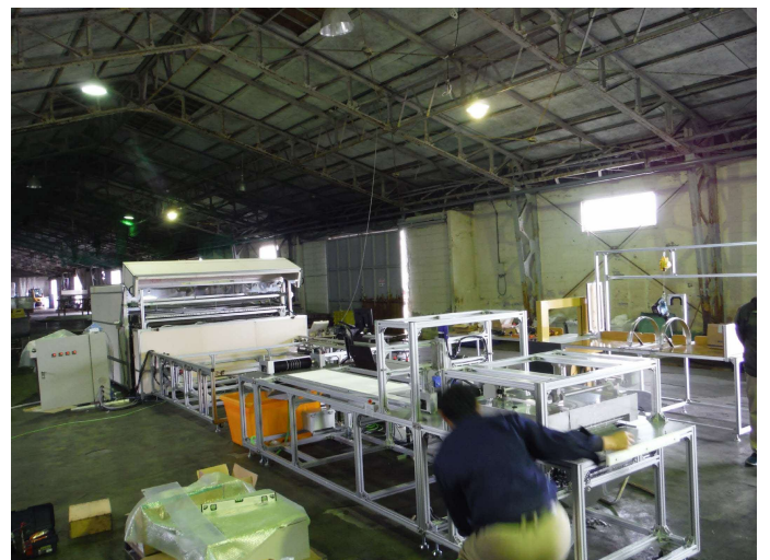
コンブ乾燥システム全景
