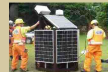
機動観測機器の設置
