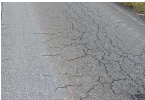
【現況】沈下によるひび割れ、わだち掘れ障害
