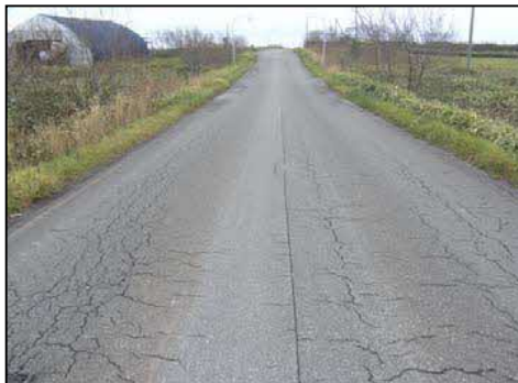
【現況】沈下によるひび割れ、わだち掘れ障害
