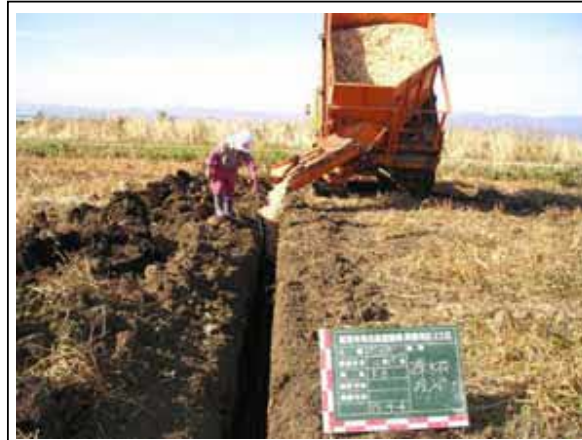
専用投入機による木材チップの投入状況
