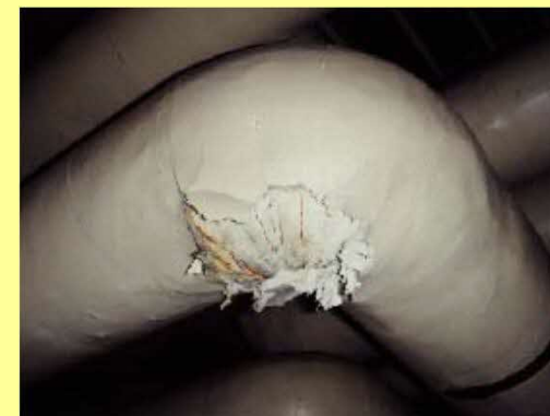
アスベスト保温材 (配管の断熱被覆)
