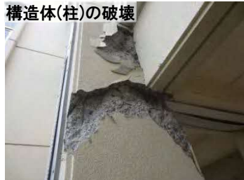
構造体(柱)の破壊
