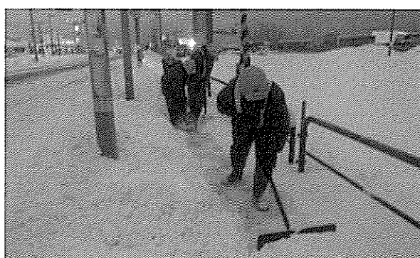
電柱の周辺は人力除雪となるため、効率が低下（国道36号 苫小牧市）
