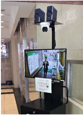
(エントランスホールの体温測定サーマルカメラ)
