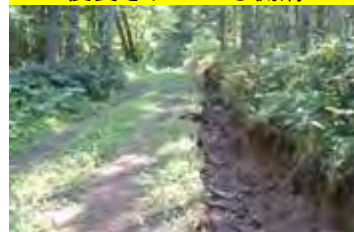
侵食されている側溝
