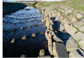
経年劣化により連結ブロックが波打った排水路
