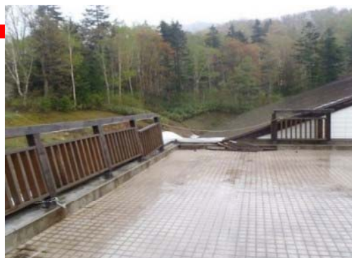
(森林学習センター屋上 柵破損状況)
