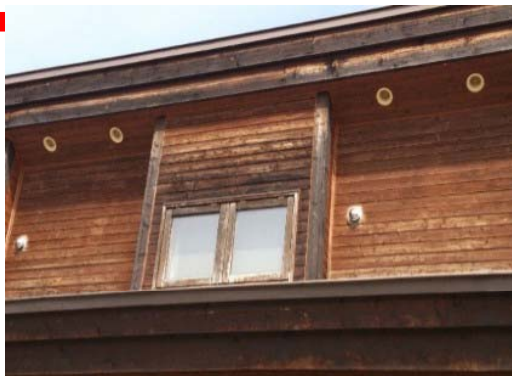
(宿泊棟 経年劣化による防腐剤塗装剥離状況)
