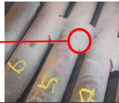
火炉下部パス管 (缶右) 損傷
