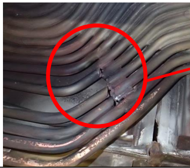
火炉下部パス管 (缶左) 損傷
