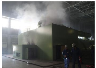
タービン出火状況
