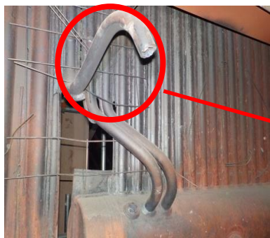
火炉出口部側壁管 (缶左) 損傷
