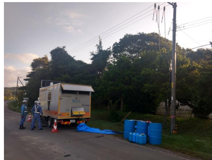
移動発電機車による応急送電
