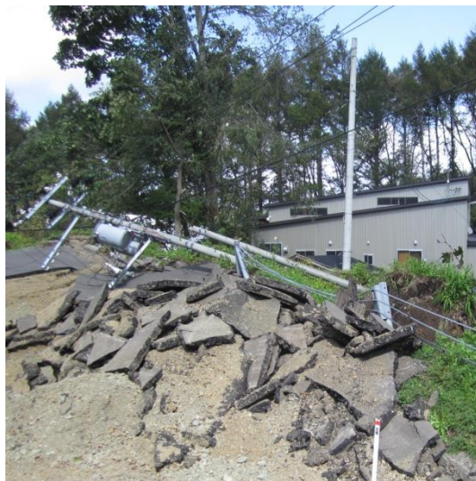
倒壊した柱上変圧器柱
