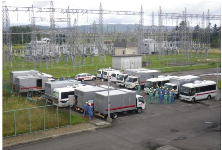
西滝川変電所で待機中の四国電力発電機車
