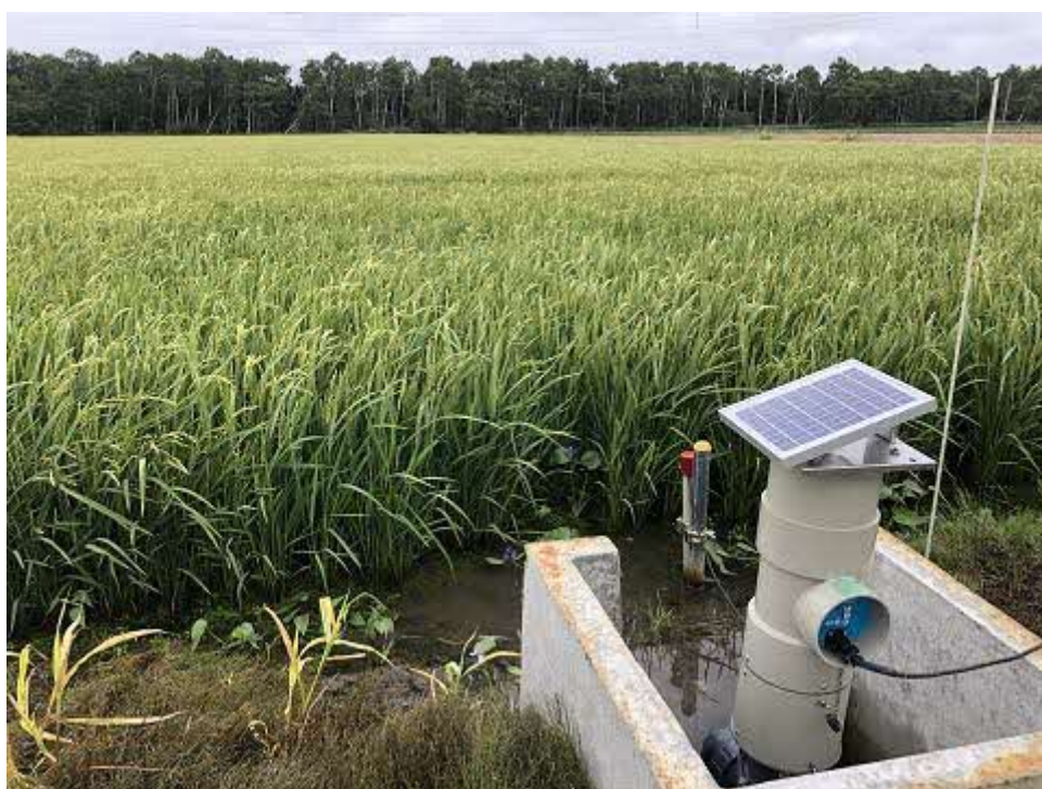
【動力（電源）は太陽光パネルを利用】
