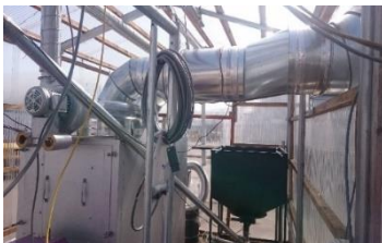
ペレット暖房設備
