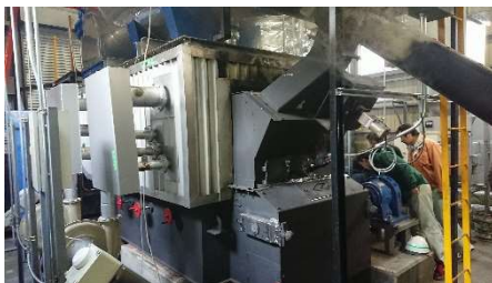
RDF ボイラー
