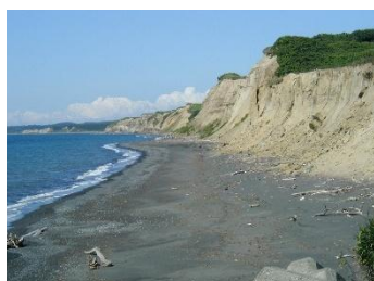
海食崖侵食状況
