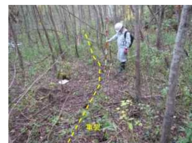
地すべり地内の市道脇法面の亀裂
