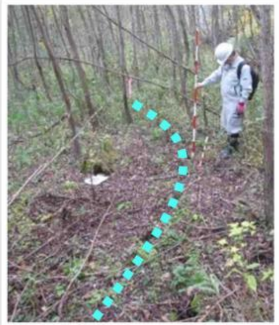
市道脇法面の亀裂（水色破線） （撮影月：令和4年5月）
