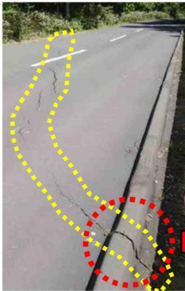
市道舗装の亀裂（黄色破線）と市道縁石の亀裂（赤色破線） （撮影月：令和3年6月）
