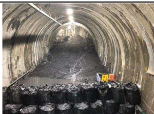
トンネル坑内土砂流入状況
