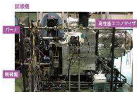
中小企業庁 HP より ボイラ本体
