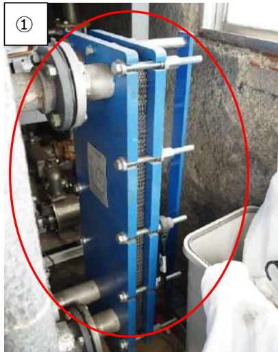
(1) ボイラー室未断熱箇所 (①・②ともに約80℃)
