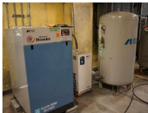
コンプレッサー室
