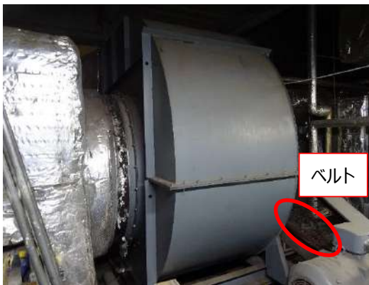
【ボイラ室空調機のモーター】
