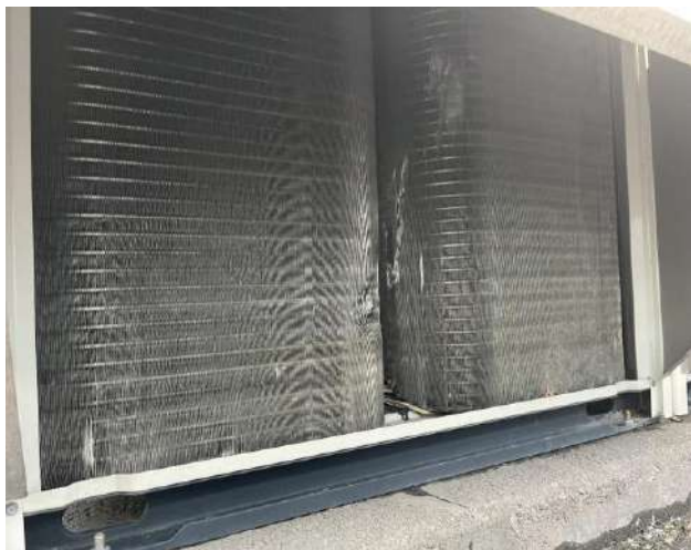
【室外機フィン部分】
