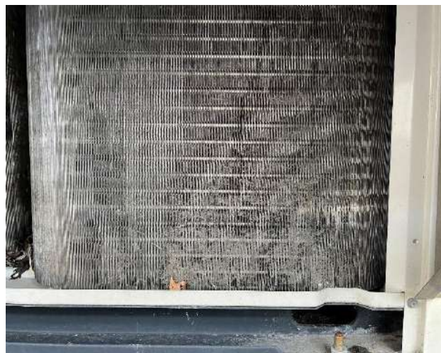
【室外機フィンに付着した汚れ】
