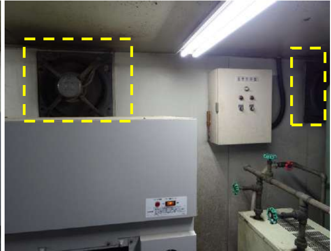
【常時運転中の換気ファン2台】
