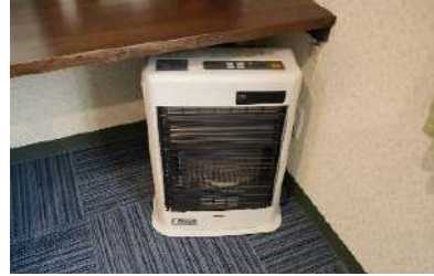
寒冷地仕様エアコンが設置され、冬期にFF暖房機を使用している客室が8部屋ありました。 (部屋番号：211、212、251-253、255-257)
