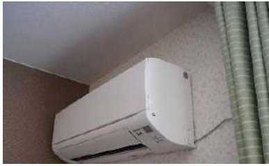
冷房専用として使用しているエアコンですが、厳冬期でも暖房可能な寒冷地仕様エアコンでした。
