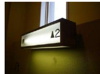
別館階段 非常用照明 (蛍光灯FL20W)
