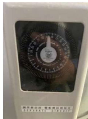
図ー 24hタイマー設置例 (貴社・蒸気ボイラ制御)
