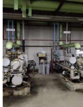
図 37kW 冷凍機（前川製）
