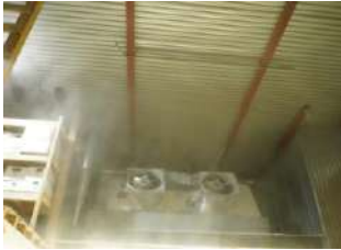
図 ユニットクーラ正面から
