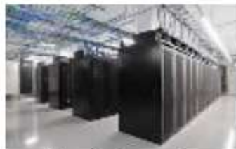
データセンター
