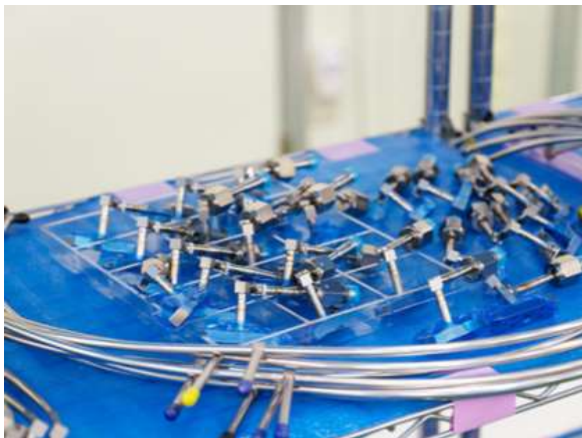
半導体製造装置の精密配管
