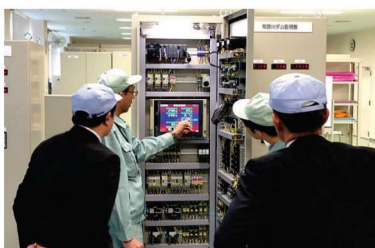
【ダム監視盤試験風景】
