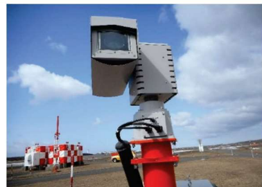
【監視カメラシステム】
