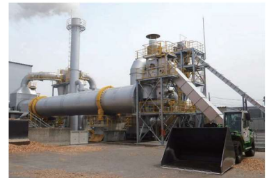
【バイオマス発電プラント】
