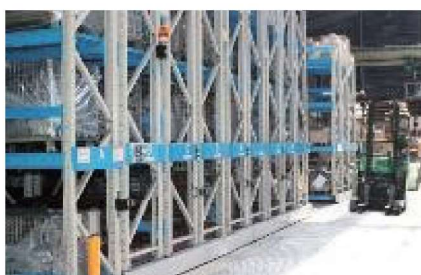
【立体倉庫管理システム】
